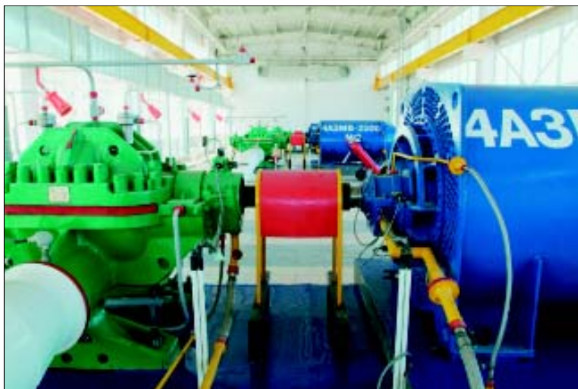
Магистральная насосная ГНПС «Уса».
